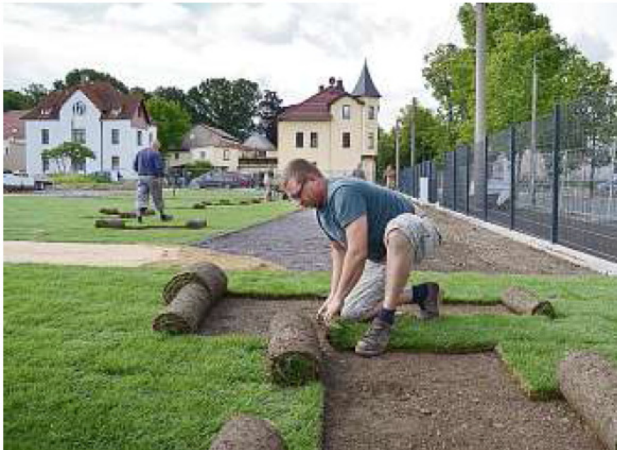
Ein Mitarbeiter der Galant Gartengestaltung und Ingenieurbüro Schirmer aus Schkeuditz legt Rollrasen auf jener Fläche der Sedlmayer GmbH in Triptis aus, auf der bis vor kurzem noch das ehemalige Bürgerhaus, eher als „Sozi“ bekannt, stand. Foto: Sandra Hoffmann
